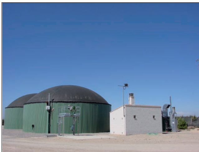
Planta de co-digestión.
