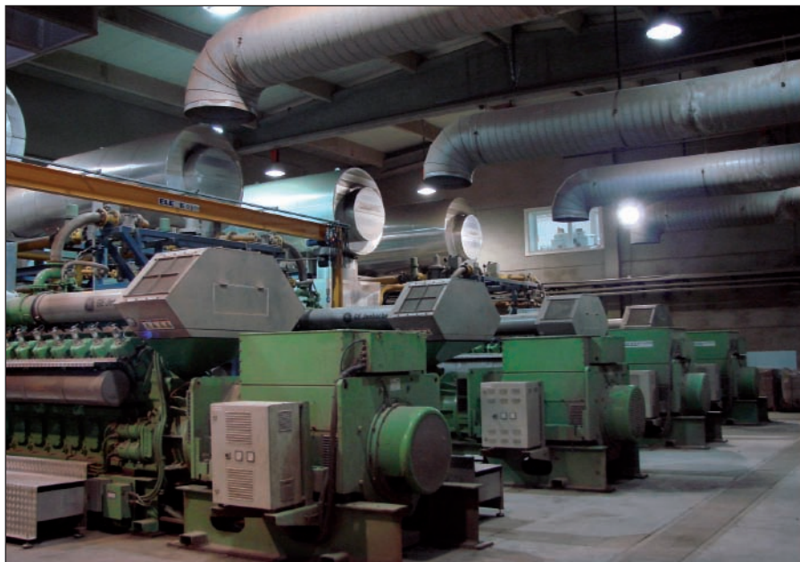
Motores para la generación de energía eléctrica.
