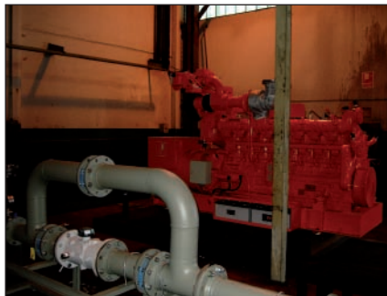
Moto-generador de syngas. Fuente: GUASCOR.
