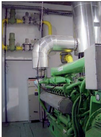
Motogenerador de syngas. Fuente: TAIM-TFG.
