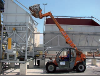
Llenado de la tolva pequeña de alimentación de biomasa. Fuente: GUASCOR.
