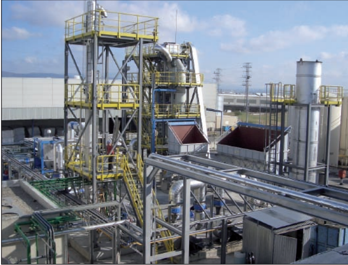
Scrubber de biodiésel. Fuente: GUASCOR.
