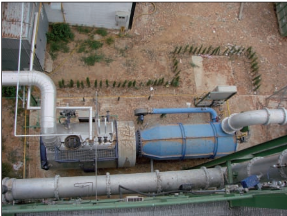
Cámara de combustión y caldera de recuperación.
