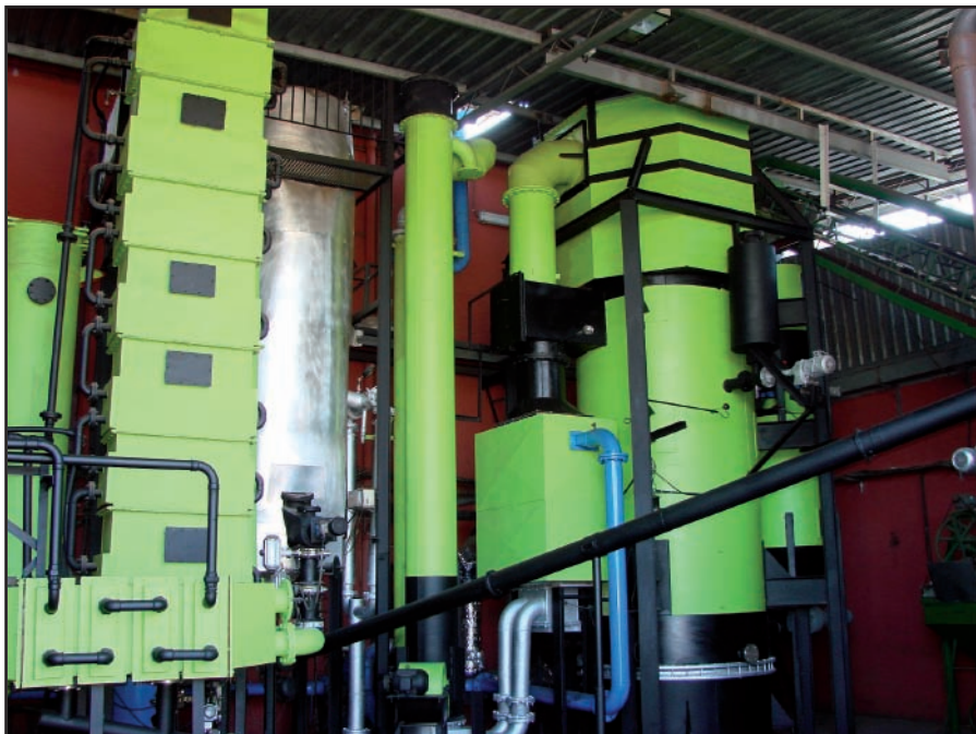
Gasificador y sistemas de tratamiento de syngas de la planta de Mora de Ebro. Fuente: ENAMORA.
