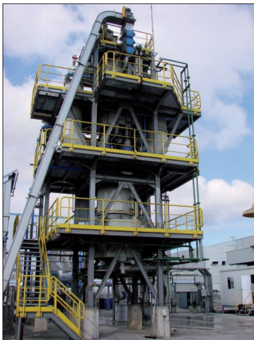
Gasificador multi-etapa de Guascor. Fuente: GUASCOR.
