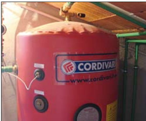
Figura 6.5: Depósito acumulador de agua caliente sanitaria.
