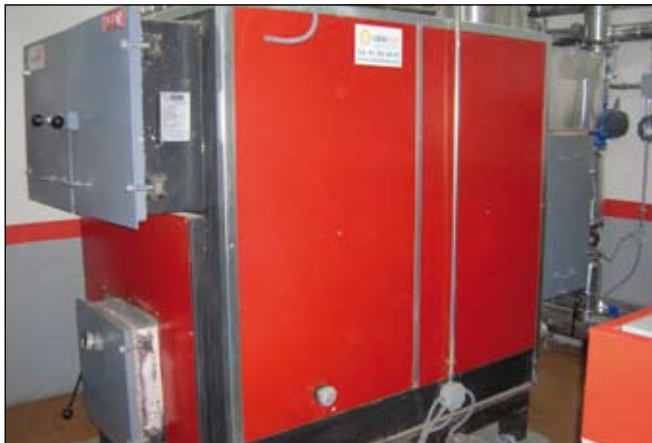
Figura 6.3: Caldera de biomasa.
