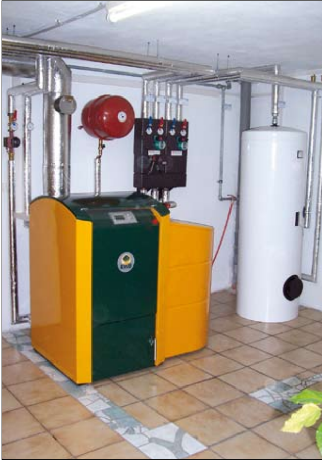
Figura 4.3: Caldera de biomasa.
