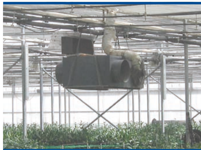
Foto 4. Generadores de calor por combustión indirecta
