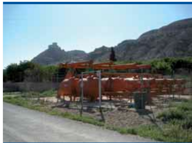
Foto 8. Estación de filtrado en un sector de riego de la comunidad de regantes de Mula
