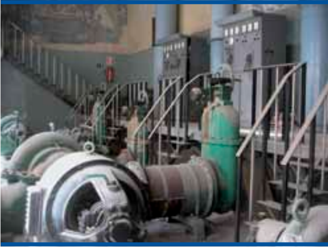
Foto 3. Equipos de bombeo antiguos en desuso en la comunidad de regantes de Lorca
