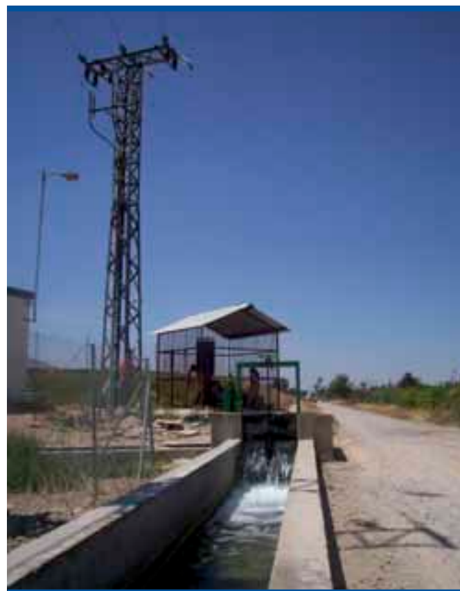
Foto 2. Bombeo alimentado por energía eléctrica en la comunidad de regantes de Albaterra
