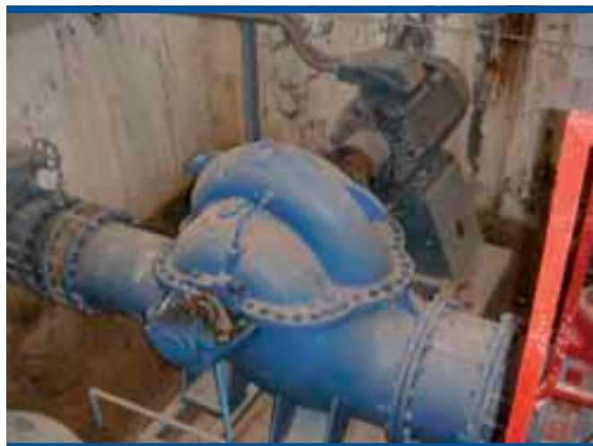
Foto 13. Bombeo con un mantenimiento deficiente
