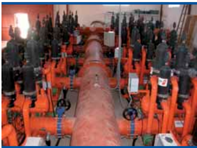
Foto 5. Sonda de presión en colector de impulsión de la estación de bombeo y filtrado de la comunidad de regantes de Albaterra
