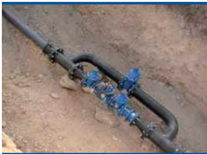
Foto 4. Válvula reductora de presión instalada en una tubería de distribución
