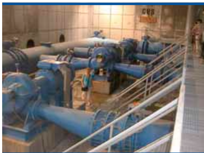
Foto 10. Estación de bombeo con grandes equipos en la comunidad de regantes de Lorca
