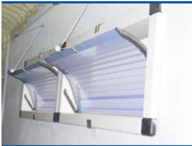
Figura 3.7. Sistema de ventilación natural con control automático electrónico (Foto cedida por Asdrubal Neves)
