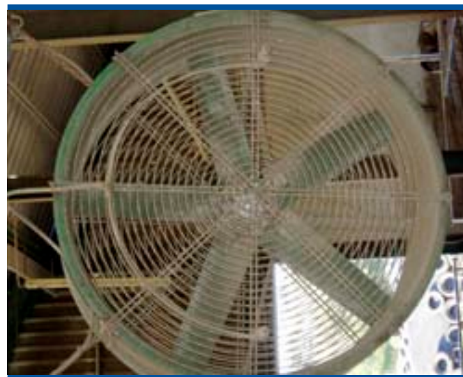
Figura 3.10. Sistema de refrigeración evaporativa basado en nebulizadores asociados a ventiladores que operan por impulsión
