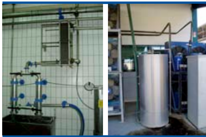
Figura 3.11. Sistema de preenfriamiento de la leche mediante intercambiador de placas con agua fría (imagen de la izquierda) y acumulador aislado para almacenar el agua caliente obtenida mediante recuperación del calor de condensación del tanque de enfriamiento de la leche (imagen de la derecha)
