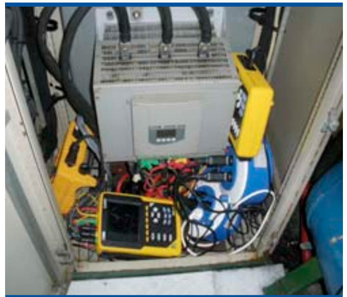
Fig. 4.5. Sensor eléctrico para alterna y continua (Fuente y elaboración propias)
