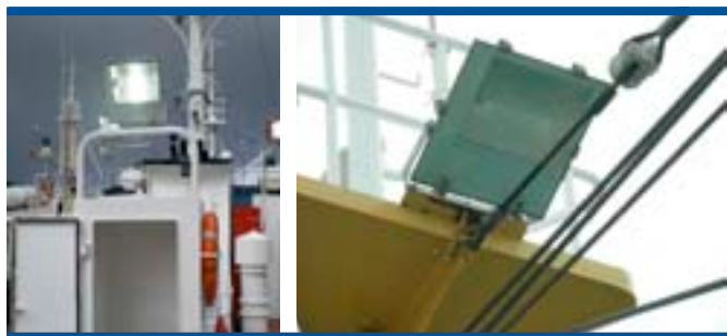
Fig. 7.3 y 7.4. Nuevos equipos de iluminación exterior según criterios de mejora de la eficiencia energética (Fuente y elaboración propias)
