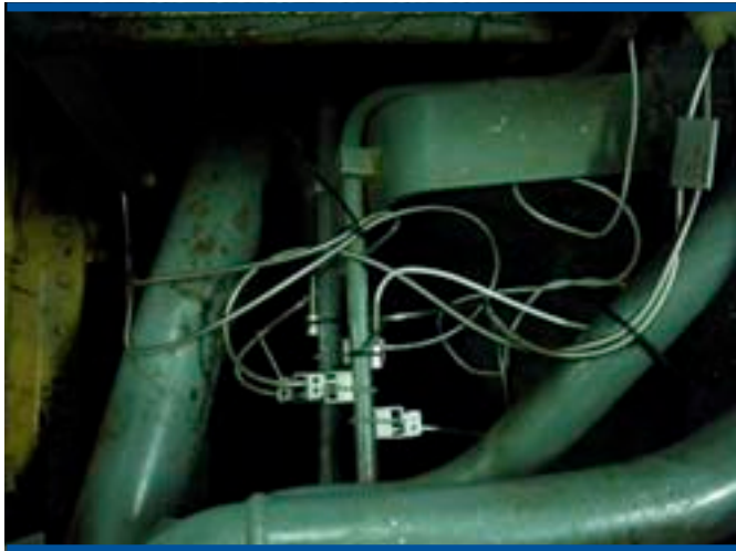
Fig. 4.2. Sensores (detalle del detector de caudal) (Fuente y elaboración propias)
