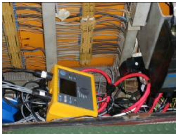
Registrador eléctrico de alterna.
