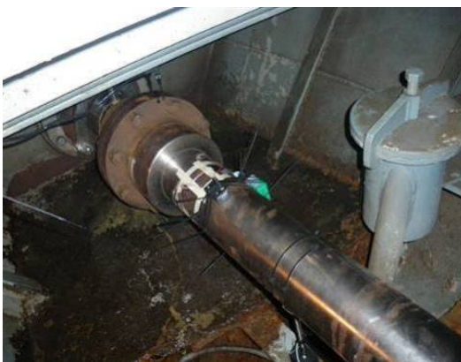
Galga extensiométrica instalada en el eje del buque.
