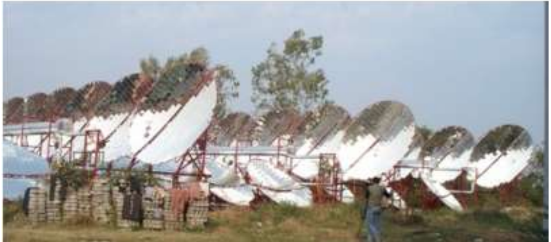
Figura 44: Sistema de aire acondicionado con discos parabólicos tipo Scheffler en India. (Fuente: Solarthermalworld)
