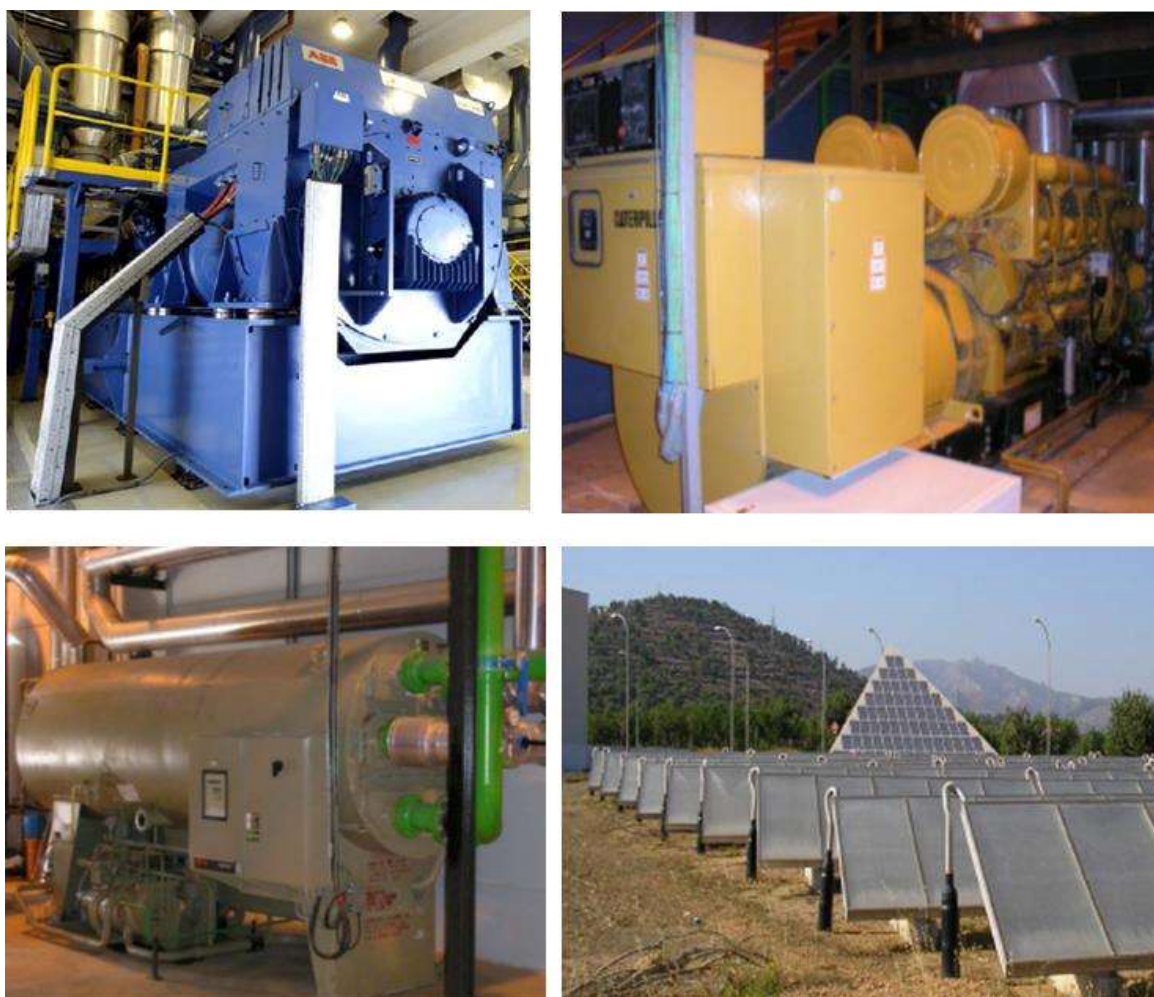
Figura 4: Fotografías de la red de climatización ParcBit. (Fuente: SAMPOL)
