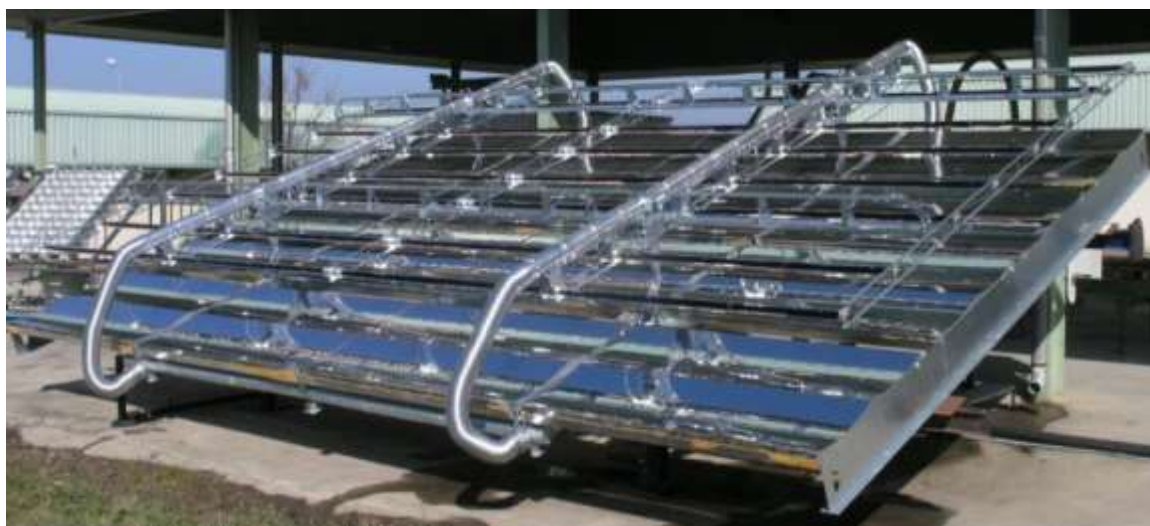
Figura 41: Colector CCStar. Instalación del Instituto del Corcho en Mérida. (Fuente: TSC)
