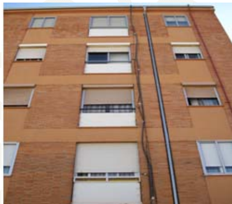
Figura 3. Fotografía de una fachada con conducciones exteriores antes de rehabilitar
