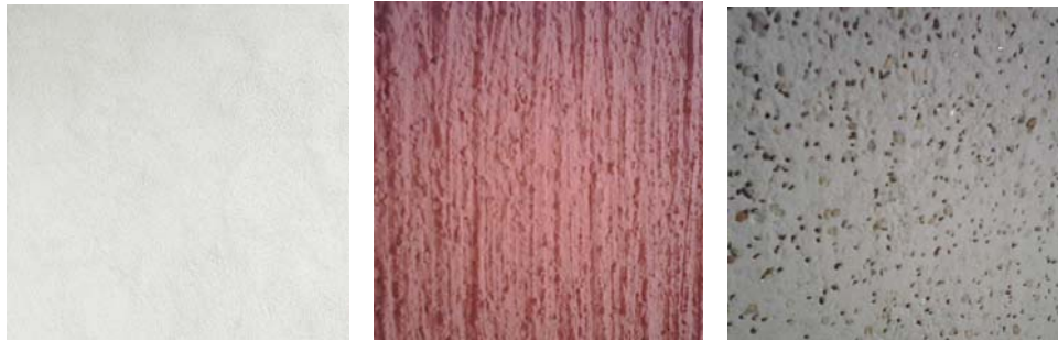
Figura 34. Texturas con efecto dado por rodillo de trapeado, con efecto por llana dentada triangular y liso con áridos proyectados
