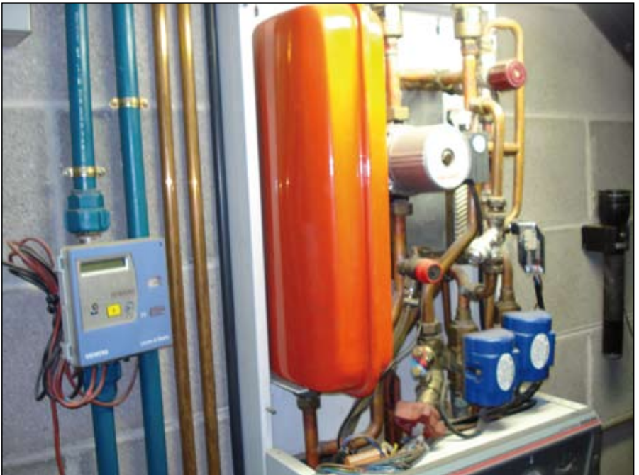
Módulo de intercambio de calor individual.
