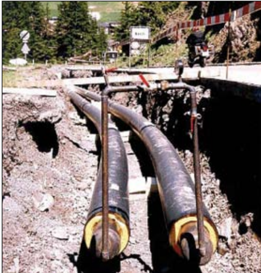
Red de tuberías para district heating .
