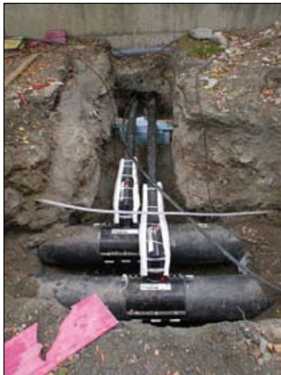
Acometida de la red de distribución térmica.
