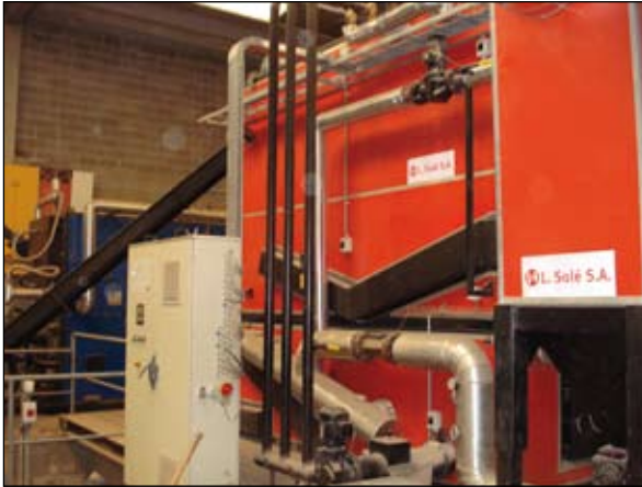
Caldera de 2 MW de potencia de tecnología L. Solé.
