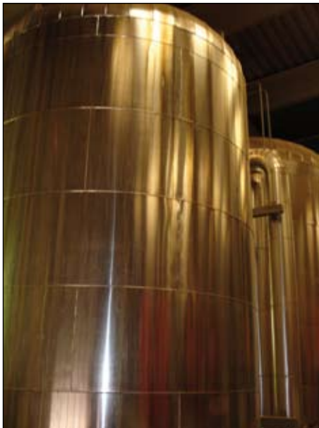
Acumuladores de agua caliente de 100 m 3 cada uno.
