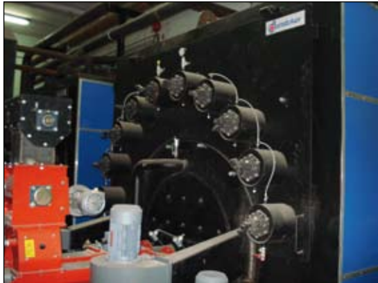
Sala de calderas tecnología Danstoker.
