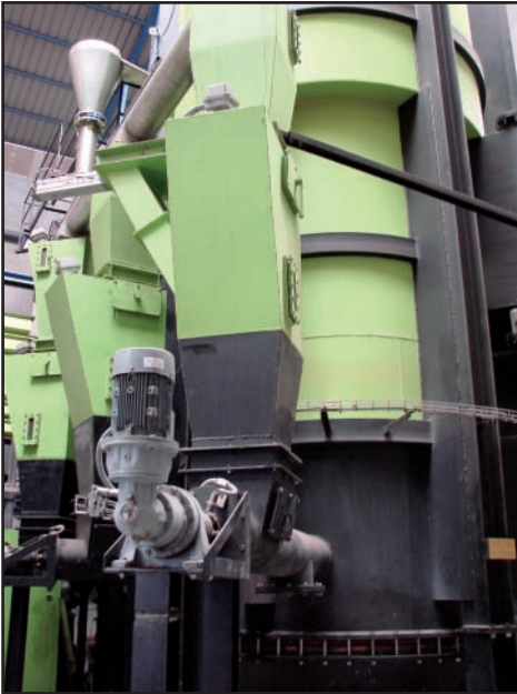
Vista de dos de las bocas del sistema de alimentación del gasificador.
