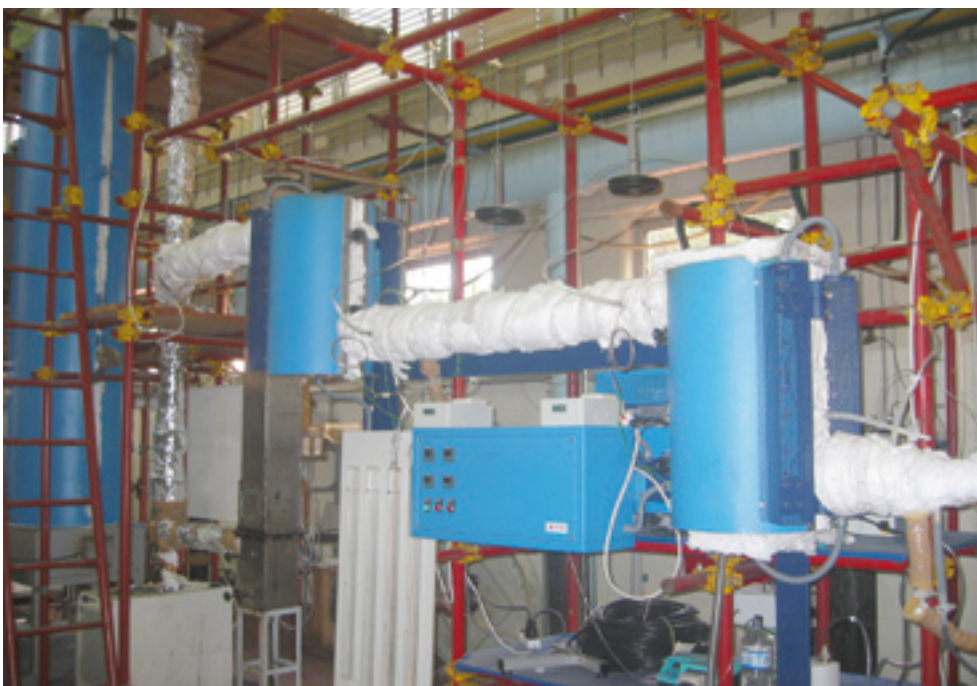
Figura 5 Instalações de gasificação existentes no INETI
