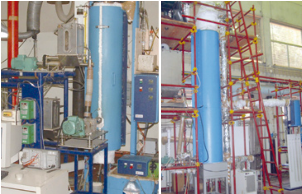
Figura 4 Instalações de gasificação existentes no INETI
