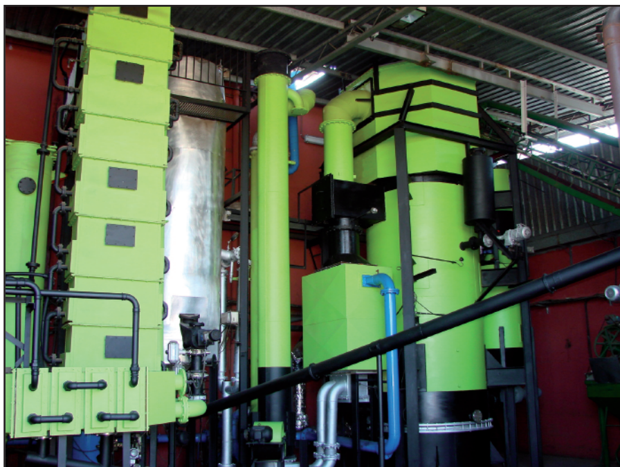
Gasificador y sistemas de tratamiento de syngas de la planta de Mora de Ebro. Fuente: ENAMORA.
