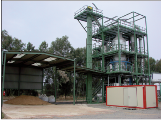
Planta de gasificación de INERCO.
