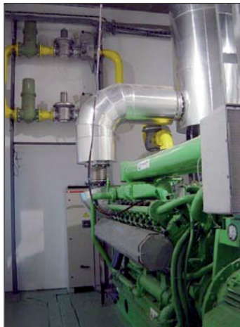
Motogenerador de syngas. Fuente: TAIM-TFG.
