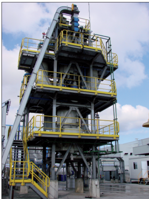
Gasificador multi-etapa de Guascor. Fuente: GUASCOR.
