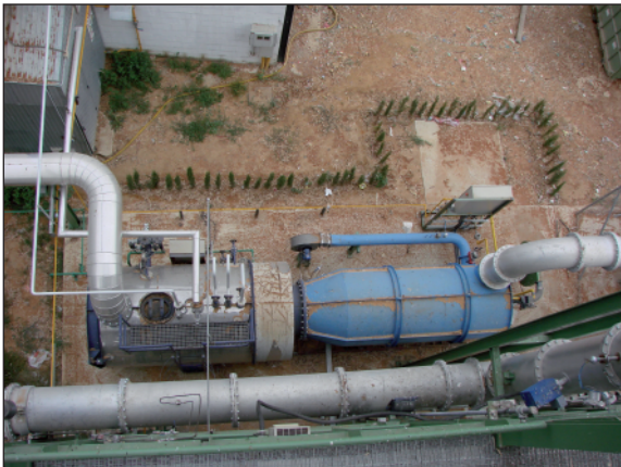
Cámara de combustión y caldera de recuperación.
