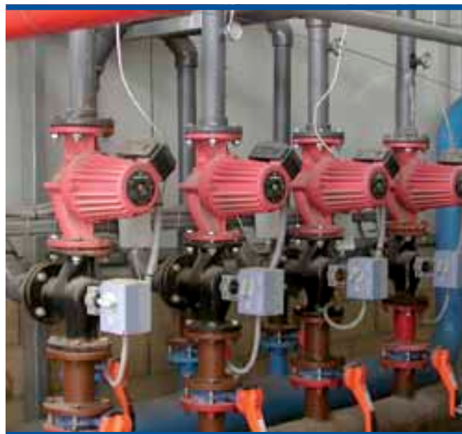
Foto 19. Bombas de impulsión de caudal variable para la distribución del agua de calefacción en invernaderos
