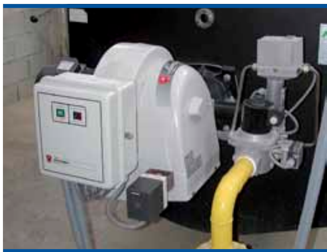
Foto 14. Quemador modulante en una caldera para calefacción de invernaderos
