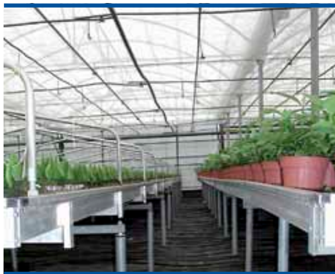
Foto 17. Tuberías de calefacción instaladas bajo las mesas de cultivo
