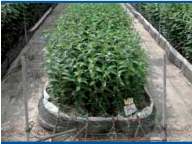
Foto 7. Instalación de tuberías de calefacción alrededor del sustrato en el invernadero analizado en Mendigorría
