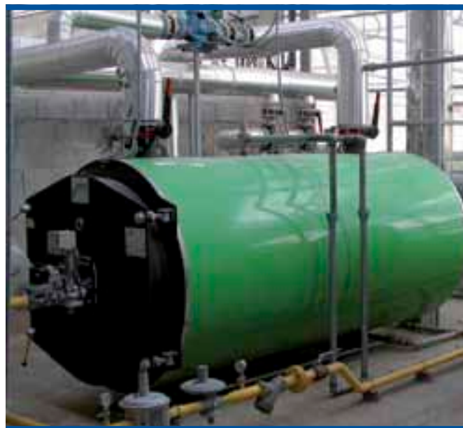
Foto 15. Aislamiento de la caldera y de las tuberías de calefacción mediante coquillas
