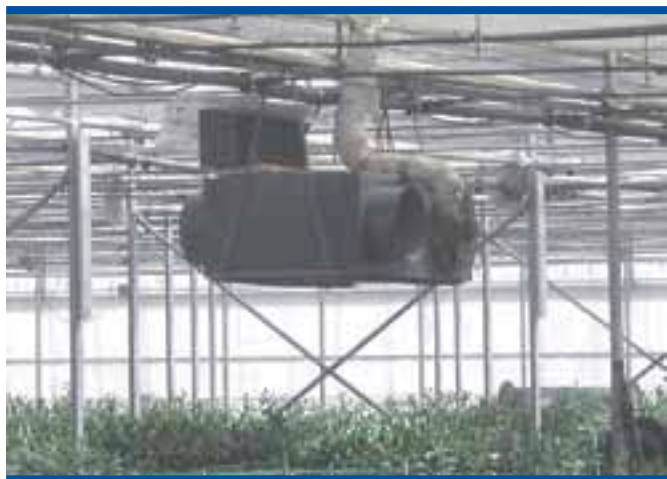
Foto 2. Generadores de calor por combustión indirecta
