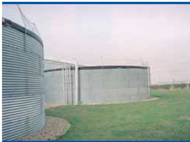
Foto 21. Depósito calorifugado para el almacenamiento de agua caliente para calefacción de invernaderos
