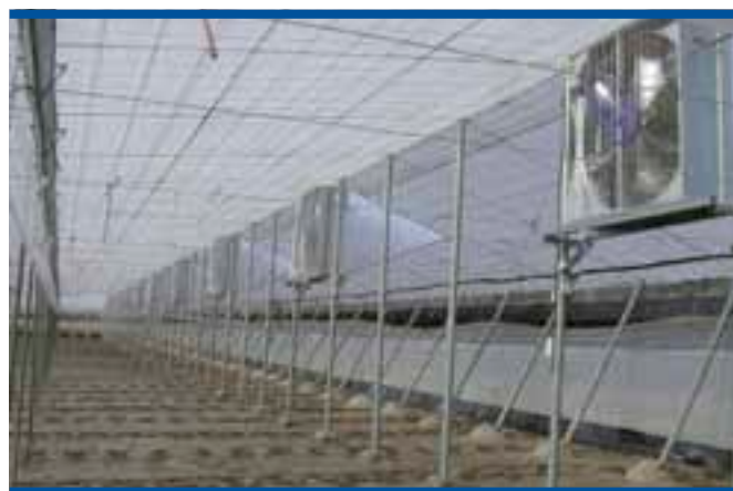
Foto 25. Grupo de extractores instalados en un invernadero de tipo Almería
