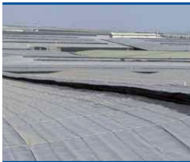
Foto 24. Aberturas cenitales de ventilación en un invernadero de tipo Almería cubiertas por malla anti-insectos
