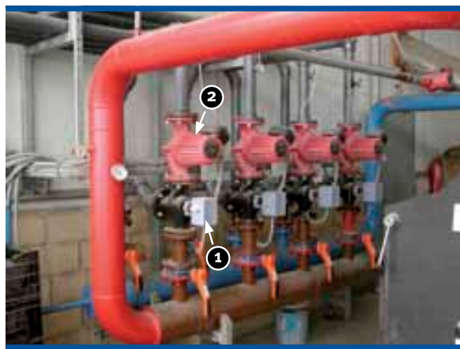
Foto 4. Instalación de calefacción por agua con válvulas de tres vías (1) y bombas de caudal regulable (2)
