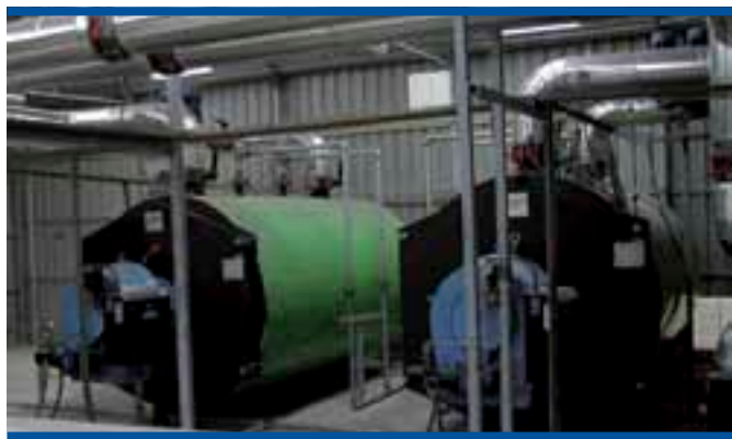
Foto 20. Instalación de calefacción en un invernadero con dos calderas para generación de agua caliente
